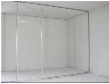
1. ฟูพลาสติก ติดตั้งโครงคร่าวผนังโซลิด ด้วย 50 มม.
